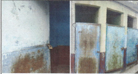
Foto 1: Mantenimiento a estructura puertas (lijado, cambio de tubo , cepillado, sujeciones, aplicación de pintura)
